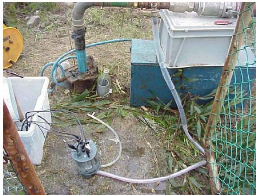
Figura D.1: Medición de parámetros de campo del agua subterránea, en la salida del bombeo
